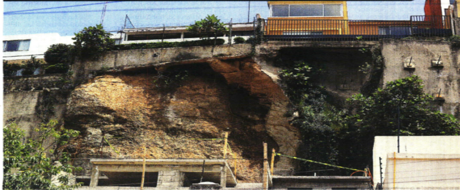
EN ALERTA. Un deslave en un muro de contención se registró el 21 de julio, por lo que una casa fue desalojada.
