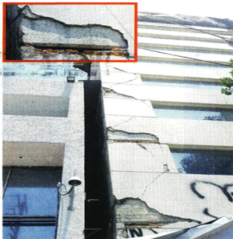
El inmueble, situado sobre Avenida Cuauhtémoc, quedó abandonado tras sufrir daños en el sismo de 2017.
