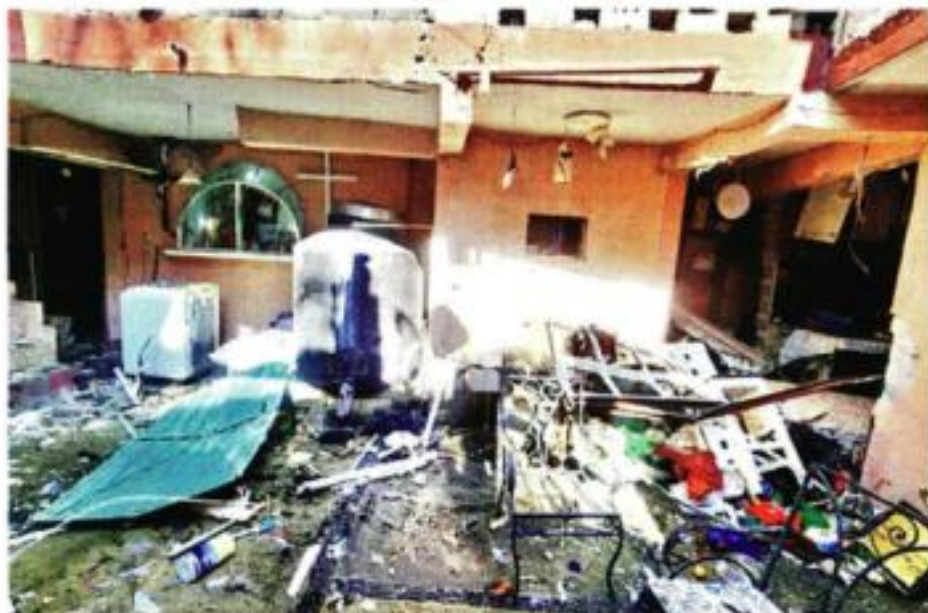
Algunos muros de la vivienda se vinieron abajo. Protección Civil evalúa si tiene daño estructural.
