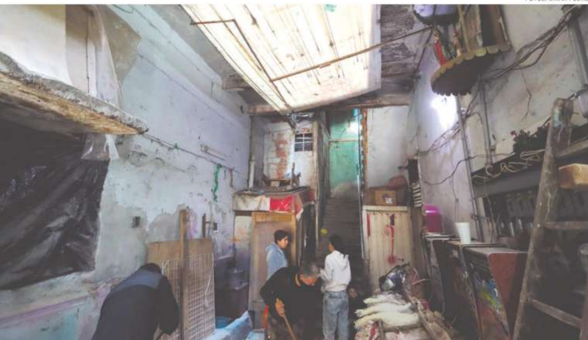
Así luce el interior de las viviendas del edificio en República de Honduras 54, ubicado en alto riesgo de colapso
