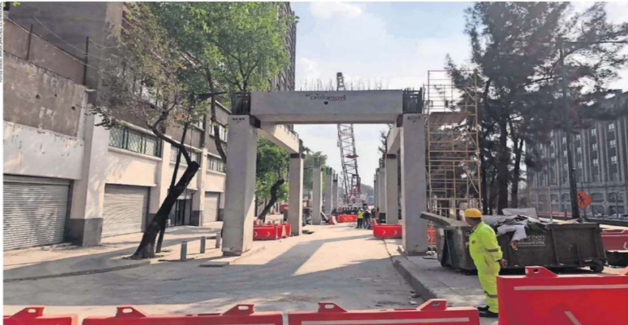
En las inmediaciones de la Plaza Tlaxcoaque ya pueden observarse las primeras columnas y traveses que sostendrán la Calzada Flotante.
