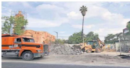
Las obras continúan, el INAH ha realizado acompañamiento desde que encontraron algunos vestigios, dijo titular de la Sobse.
