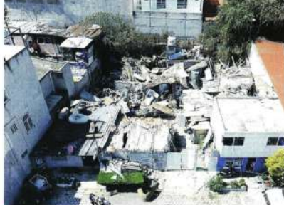
Unas 250 personas evacuaron la zona y 50 viviendas resultaron con algún tipo de daño.
