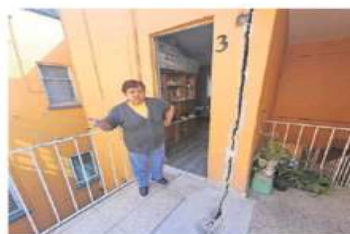
El edificio en Los Echave 34 quedó dañado tras los microsismos registrados a finales del año pasado.
