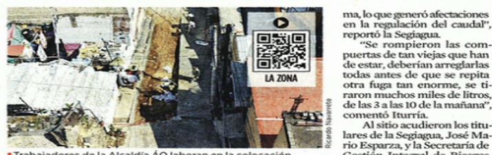
Trabajadores de la Alcaldía AO laboran en la colocación de costaleras para evitar que se forme un socavón.
