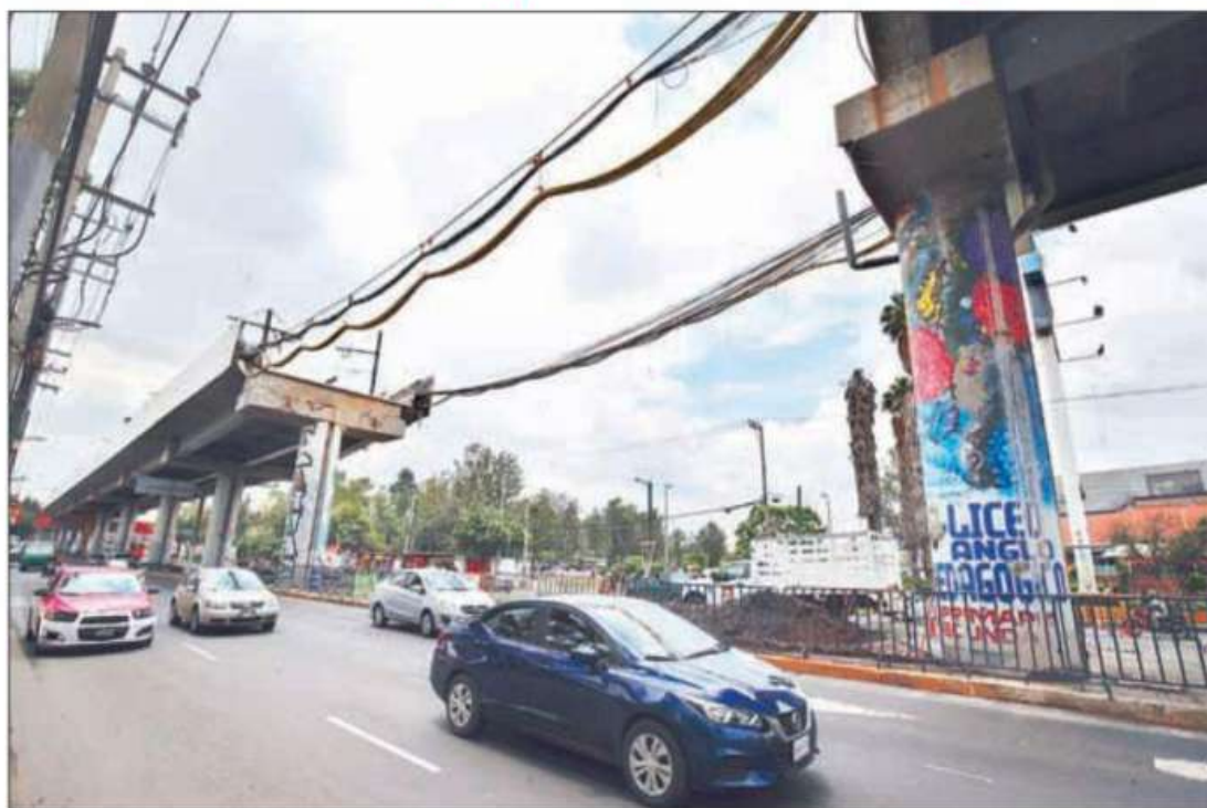
▲ La llamada "zona cero", donde uno de los convoyes de la línea 12 del Metro cayó al vacío al colapsar una trabe entre las estaciones Tezonco y Olivo, con saldo de 26 personas fallecidas, mantiene su tránsito vehicular tras ser reabierto la avenida Tláhuac. Claudia
