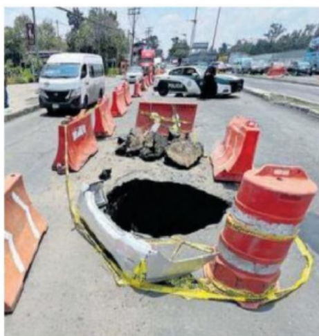
Otro socavón se formó en el cruce con Churubusco
