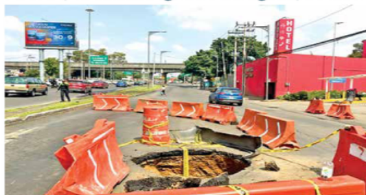
Un socavón en calzada Ignacio Zaragoza y la calle Agua Caliente tiene cerrados carriles laterales de la vía primaria.
