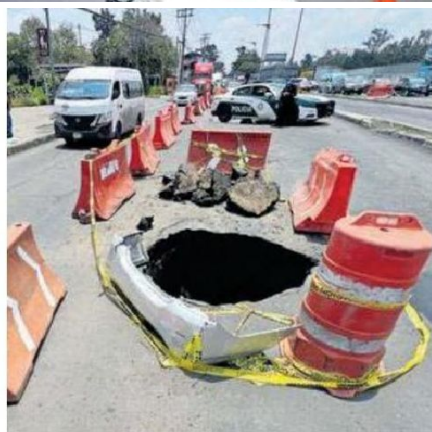
Otro socavón se formó en el cruce con Churubusco
