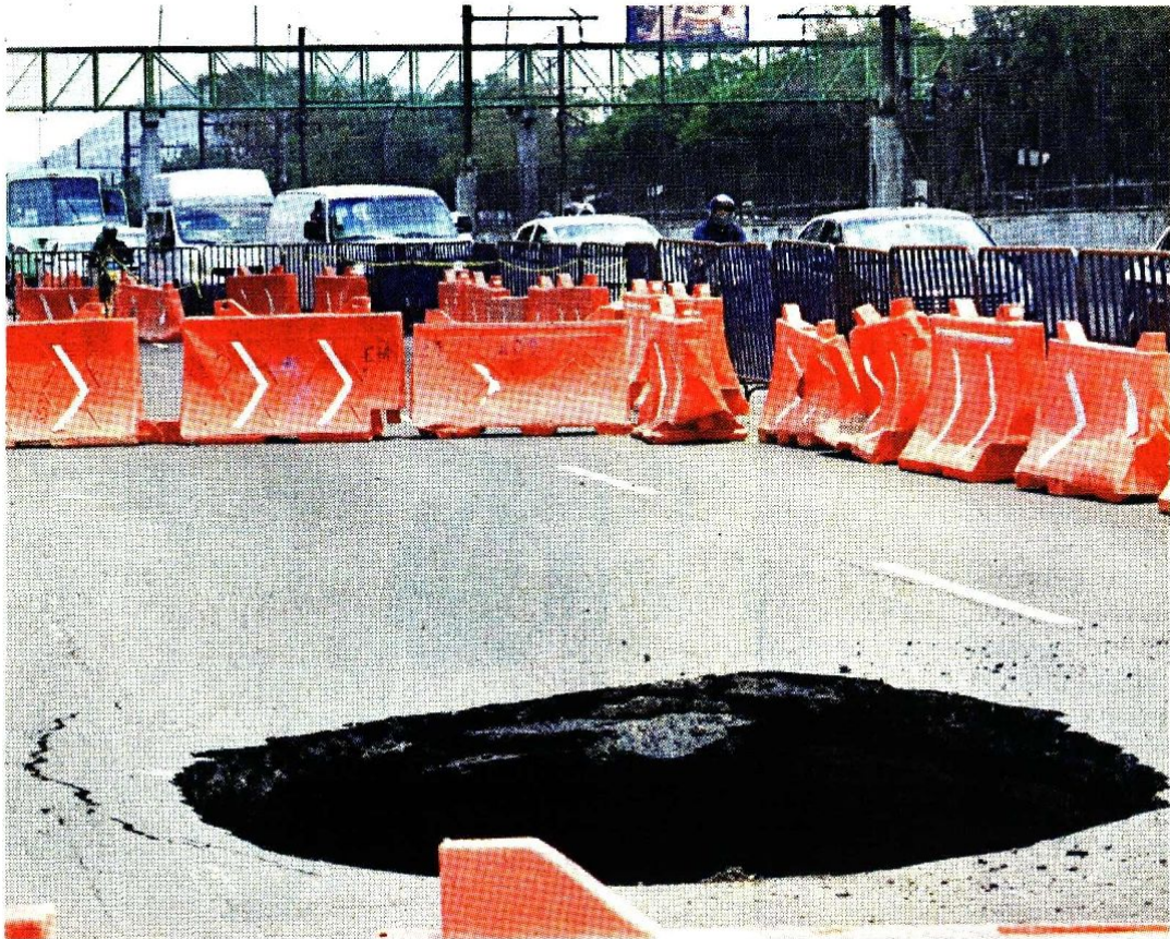
EN PLENA VIALIDAD. Personal de la Segiagua trabaja en el cierre del socavón de 4.5 metros de profundidad registrado en carriles centrales de Calzada Ignacio Zaragoza.
