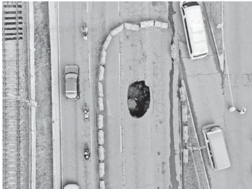
El primer socavón apareció la tarde del martes 12 de agosto, sobre los carriles centrales y el cruce con Río Churubusco
