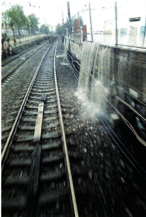
■ En la Línea A, el agua ingresó incluso a la zona de vías.
