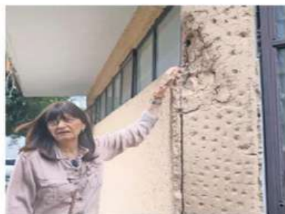
Habitantes de Patricio Sanz 529, colonia Del Valle, dicen que cada día hay mayor deterioro en el edificio.
