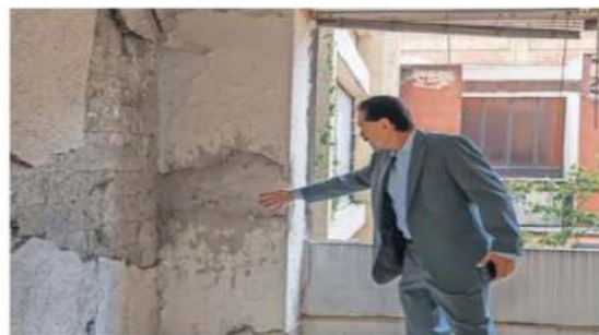
El edificio de Aguascalientes 12 tiene daño estructural y hay riesgo de colapso. Vecinos piden su reconstrucción, otros están por la rehabilitación.
