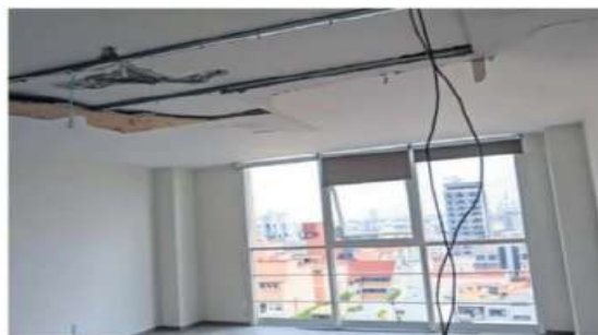
En Patricio Sanz 529 adquirieron departamentos, pero la inmobiliaria no les informó que el edificio había sido dañado en el sismo de 2017.
