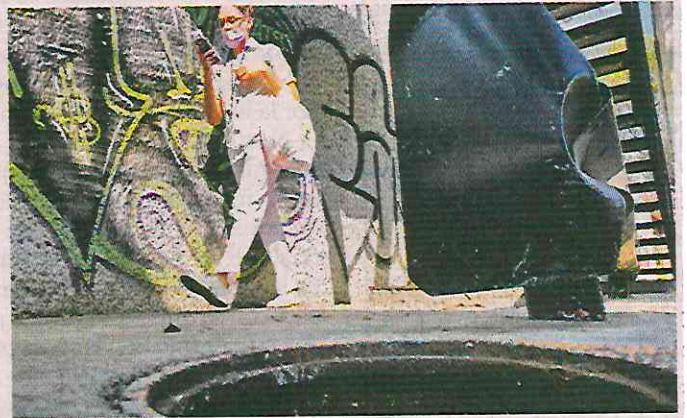
■ Sobre Circuito Interior y Callejón San Felipe, en la Colonia Xoco, está una de tantas coladeras sin tapa.
