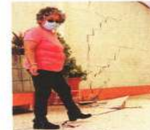
Vecinos acusan daños en pisos y paredes.
