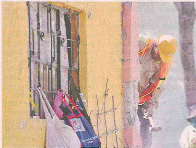
Las labores remoción de escombros siguen en esta colonia de Miguel Hidalgo desde el sábado.
