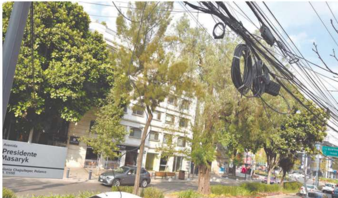
El cableado aéreo en calles de la ciudad representa contaminación visual / ARCHIVO DANIEL GALEANA
