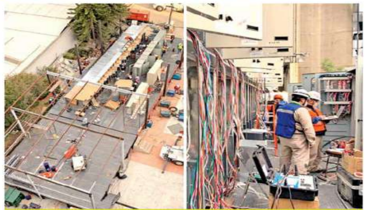
Foto: Especial AVANCE. La directora del STC, Florencia Serranía, informó de los avances en los trabajos para restablecer el servicio de trenes en las líneas del Metro afectadas.
