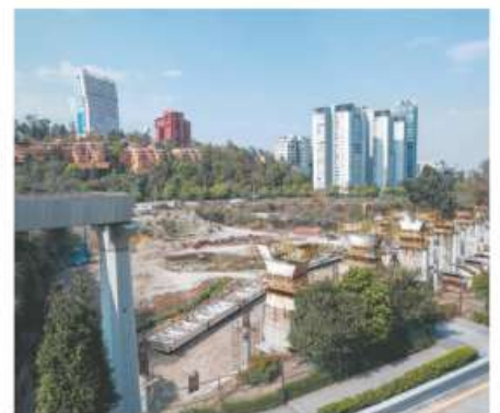
Se aplicarán a vías y sistemas de comunicación en el tramo de Observatorio /ALEJANDRO AGUILAR
