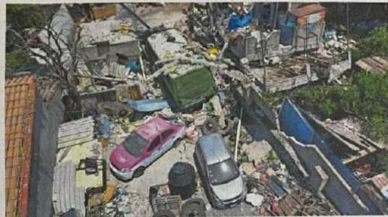
La explosión se registró la mañana de este martes en una vivienda de la colonia Miguel Hidalgo, en Tlalpan. Además, cinco inmuebles aledaños registraron daños y brigada animal rescató a ocho perros.
