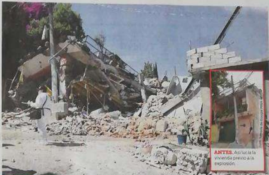
DERRUMBE. La casa de tres niveles quedó reducida a escombros tras la explosión por acumulación de gas.
