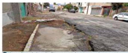
Han rellenado la calle Gitana, pero la grieta vuelve a surgir.
