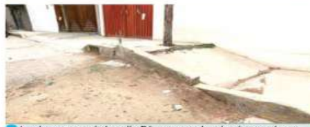
Las banquetas de la calle Pámpano se han hecho escalones.
