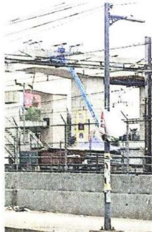
■ El trabajador de las obras cayó 50 metros de altura.
