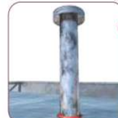
Porosidad y falta de fusión en la unión perno-trabe.
