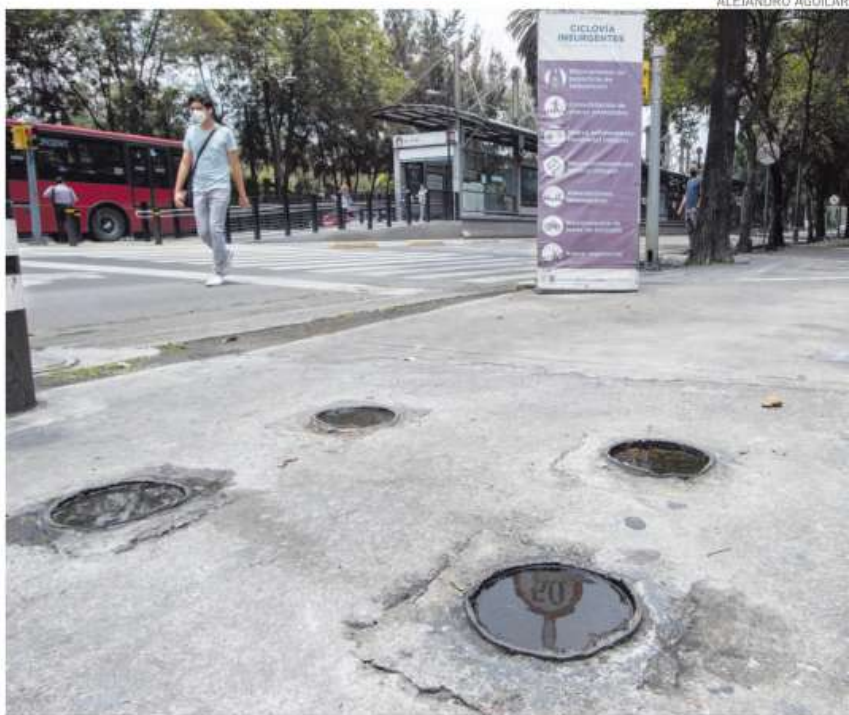
En San Simón quedó la huella del puente frente al cruce a nivel de calle
