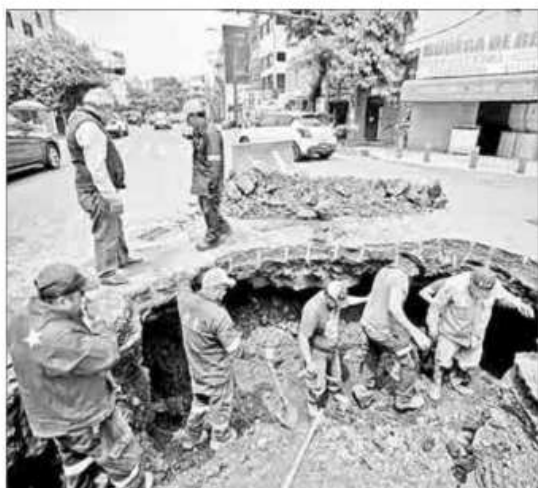
▲ Un socavón se formó en el Eje 5 Sur Eugenia y la calle Patricio Sanz, en la colonia Del Valle, alcaldía Benito Juárez, por la fractura de una tubería de agua potable. Personal del Sistema de Aguas de la Ciudad de México continuaba ayer la reparación. Foto Alfredo Domínguez
