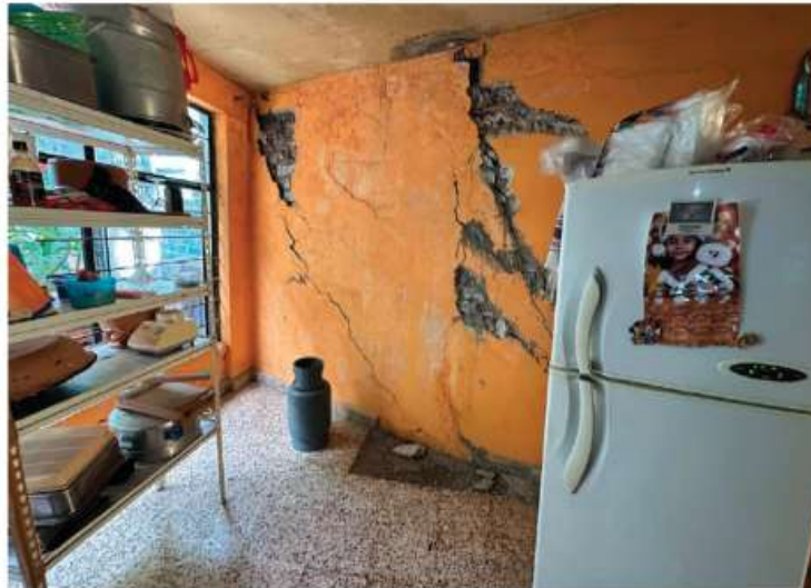
LA VIVIENDA de Daniel Díaz, en el Paraje Zacatepec, luce con grietas en sus muros y pisos, ayer.
