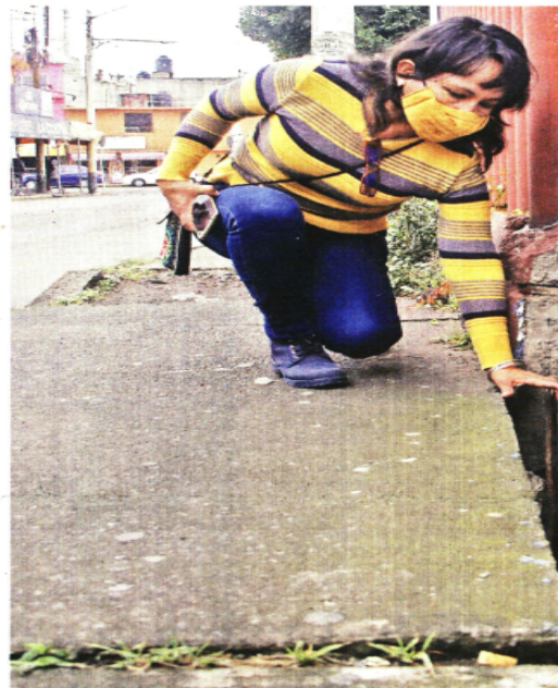
IMPACTO VISIBLE. El suelo de la Colonia Villa Centroamericana presenta grietas y hundimientos, que están asociados a la extracción de agua del subsuelo.
