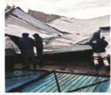
El granizo derribó la techumbre de una bodega.
