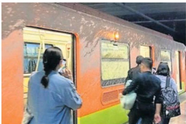
La maquinaria de una construcción particular perforó una dovela que causó la filtración de cemento a las vías y afectó a uno de los trenes.
