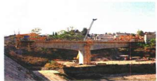
Los vecinos han expresado su temor por la construcción del Tren Interurbano México-Toluca.
