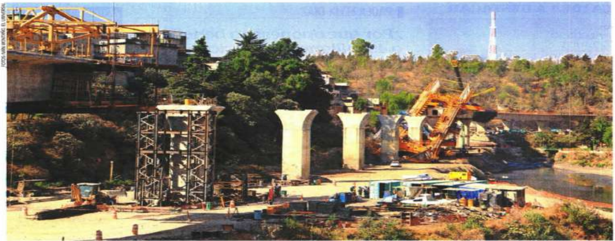
Para retirar la maquinaria, que pesa 800 toneladas, se utilizará una grúa especial en las maniobras.
