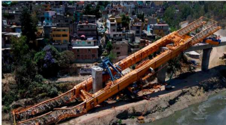
Colapsa maquinaria de más de 200 metros de largo y de 800 toneladas de peso en obras del Tren Interurbano.
