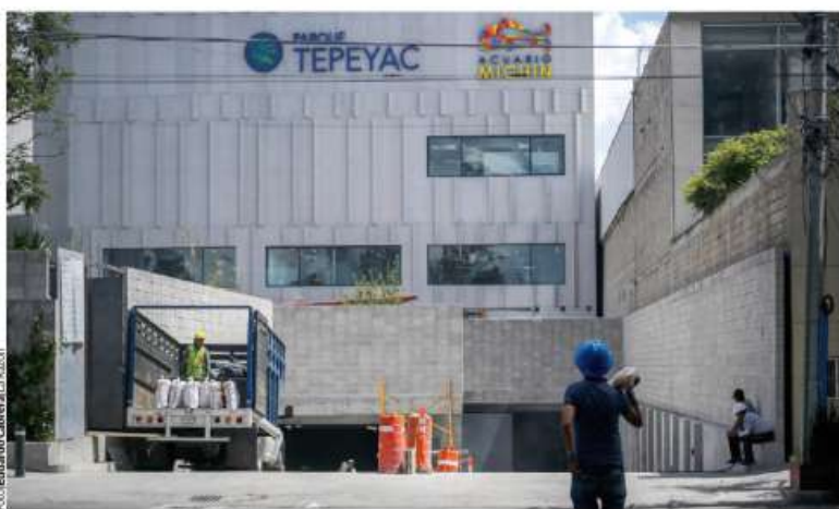
LAS OBRAS de lo que será el Acuario Michin, en Parque Tepeyac, continuaron ayer.
