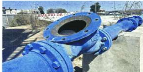
En algunos puntos, la falta de piezas es evidente.
