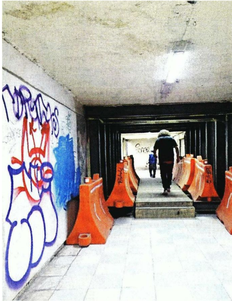
■ Aunque fueron colocadas estructuras metálicas en los sitios, locatarios acusaron que no se llevan a cabo obras.
