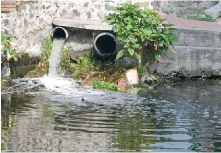
DOS TUBOS de drenaje desembocan en uno de los canales, como se aprecia en esta imagen tomada ayer.
