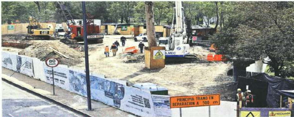
ENTRE DERRIBOS Y REUBICACIONES. La Sedema autorizó que 451 árboles del Bosque de Chapultepec fueran impactados por las obras del Cablebús; la mayoría, 361, serán trasplantados.
