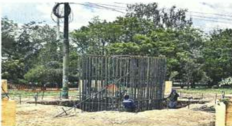
Las obras del Cablebús contemplan la instalación de seis estaciones y 40 postes.
