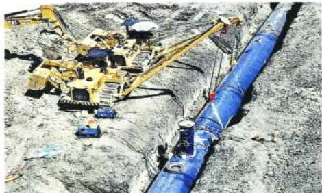
Un segmento del ducto, atrás de la Refinería de Cadereyta, es sostenido por dos grúas para apenas ser unido ayer.
