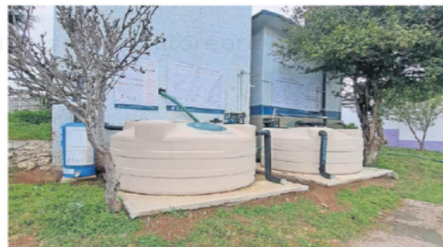
Por el momento 72 escuelas de Milpa Alta cuentan con equipos para captar agua pluvial, lo que beneficiará a 40 mil personas, informaron.
