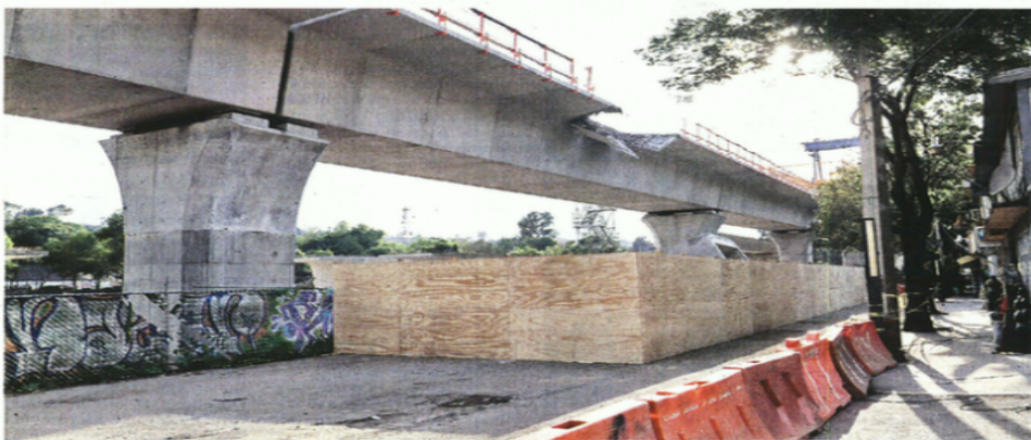
AMURALLADA. La estructura que cayó sobre una camioneta fue rodeada por un tapial de madera.
