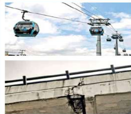
Algunos usuarios del Cablebús vivieron el sismo en las alturas. El puente de El Yaqui está bajo revisión.
