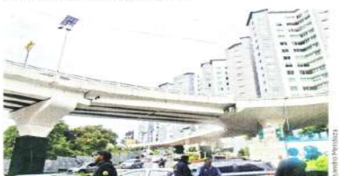
En Huixquilucan, un puente en la zona de Interlomas tuvo que ser cerrado para descartar daños estructurales.
