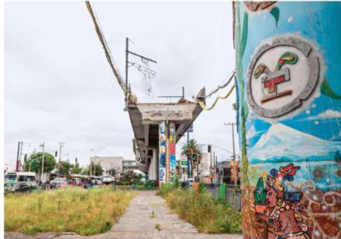
PERITAJE. De acuerdo a la Fiscalía capitalina, la mala soldadura e inexistencia de pernos, entre otros factores, fue la causa del deplome de un tramo elevado de la Línea 12.
