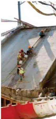
Foto: David Solís Trabajadores usaron una escalera para recabar pruebas de la trabe que está caída.
