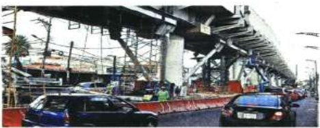
Las obras del tramo Zapotitlán-Nopalera fallaron.
