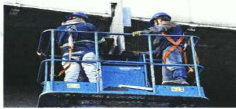
En la ruta ya se realizan trabajos de rehabilitación tras el desplome de 2021.
