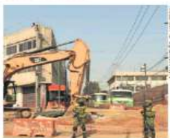
El personal de una empresa realizaba trabajos de mantenimiento en el drenaje.
