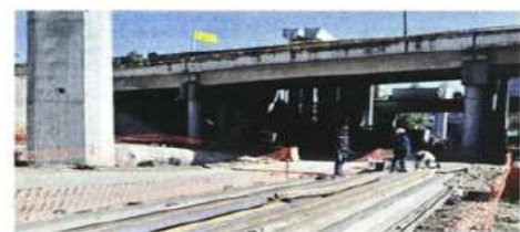
En las revisiones más recientes de la ASF, las obras del Tren Interurbano han presentado diversas anomalías.
