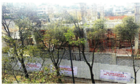
Personal de la Alcaldía acudió al lugar y, al detectar irregularidades, suspendió los trabajos que se realizaban.
