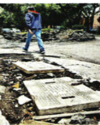
Coladeras aledañas también están pendientes de intervenir.
