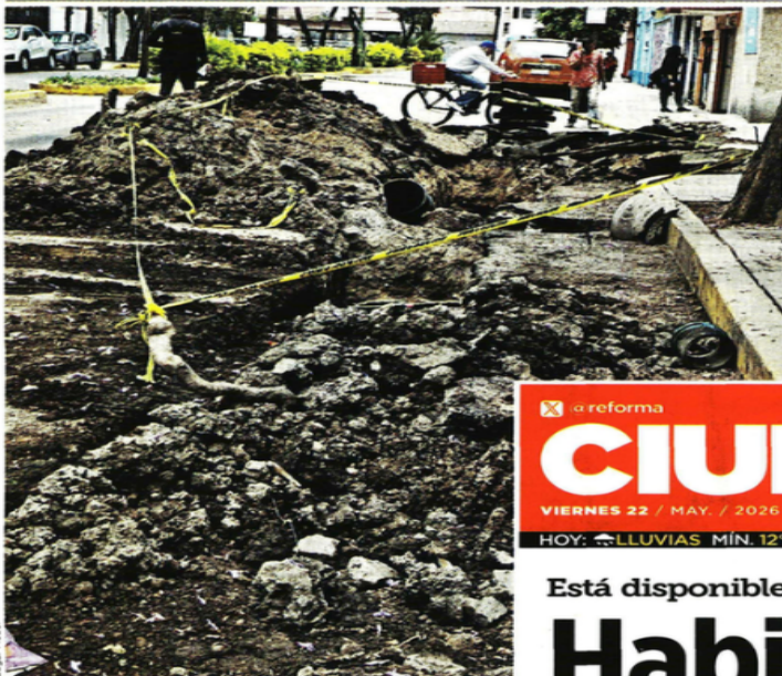
CON OBSTÁCULOS. Tuberías y restos del asfalto obstruyen un carril de Calle Candellilla.
