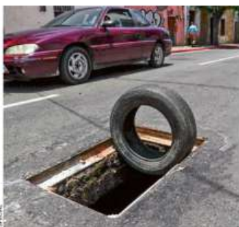
INFRAESTRUCTURA. Además de su costo, las coladeras abiertas son un riesgo para las personas.
