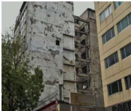
El edificio ubicado en Av. Chapultepec con el número 484 dañado en el sismo del 19 de septiembre de 2017.
