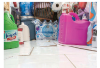
EL SUELO de la casa de Norma Trujillo está levantado y quebró el mosaico.
