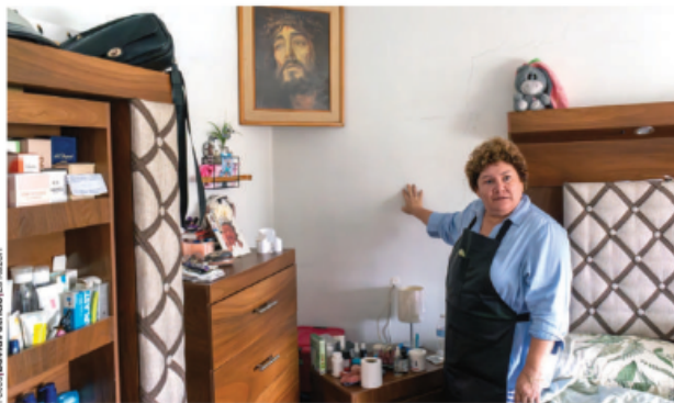
NORMA TRUJILLO muestra las grietas que hay en la pared de su habitación, ayer.
