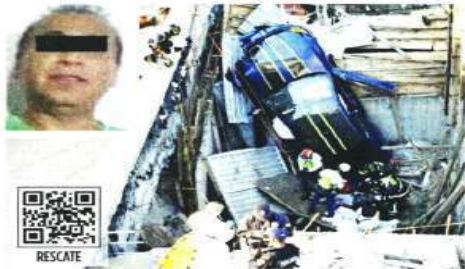
El auto BMW en el que viajaba la víctima cayó en una zona de excavación cerca de la Plaza Artz.
