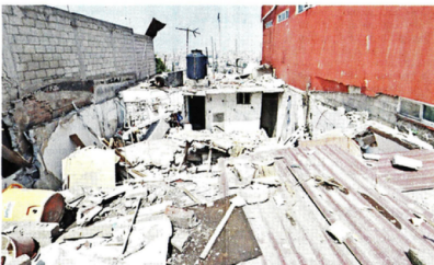
TRAGEDIA. Una de las cosas de la vivienda se vino abajo y derrumbó el primer nivel, sepultando a los habitantes, de los cuales uno murió.
