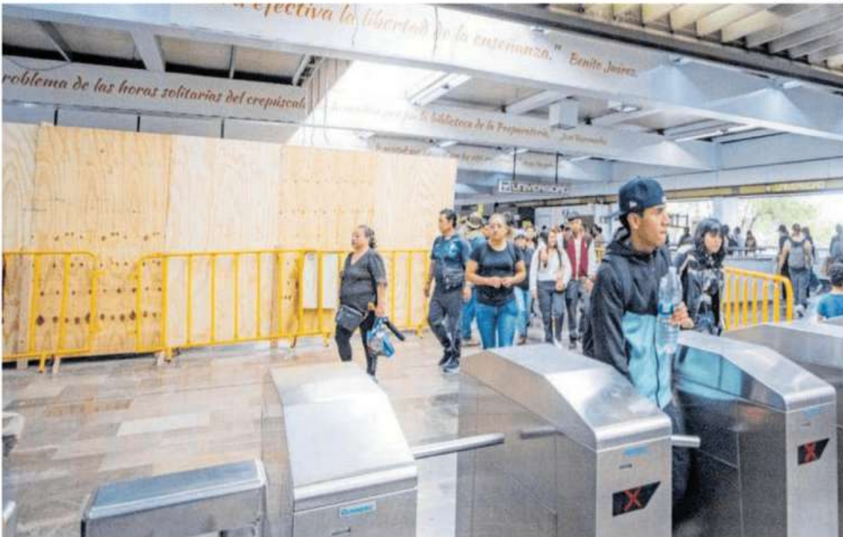
Pasajeros de Metro Universidad sortean el inicio de las obras en la estación
