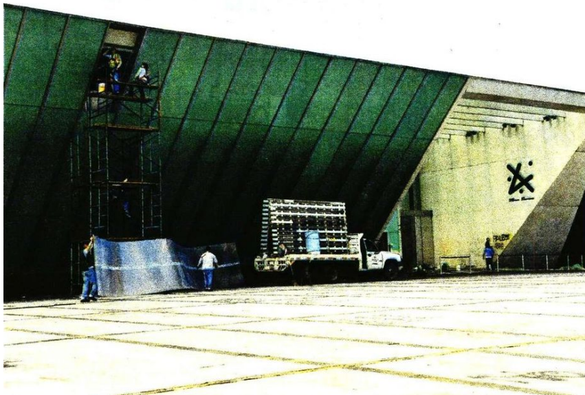
Autoridades ya trabajan en la restauración de los espacios vandalizados.
