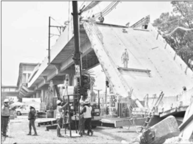
▲ Aspecto de los trabajos de remoción de escombros tras el colapso de una trabe y un vagón, la noche del 3 de mayo, en la interestación Olivos-
