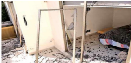
El complejo donde ocurrió el siniestro constaba de cuatro viviendas, dos de las cuales quedaron destruidas.
