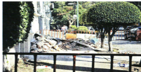
El cascajo de los inmuebles dañados por el estallido.
