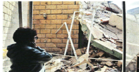
Los escombros de la casa 3 en Providencia 1017.
