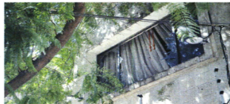
Daños en cancelería y ventanales con vidrios rotos.
